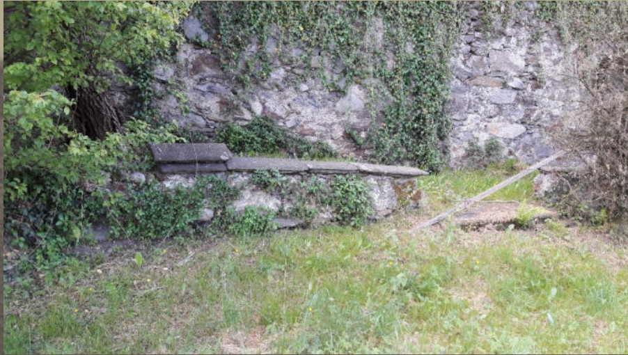
Immagine 11 - interna – Muretto degradato
